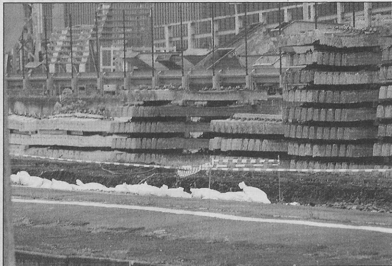
Feuerwehr und THW deckten die Fundstelle mit einer Plane und Sandsäcken ab.
